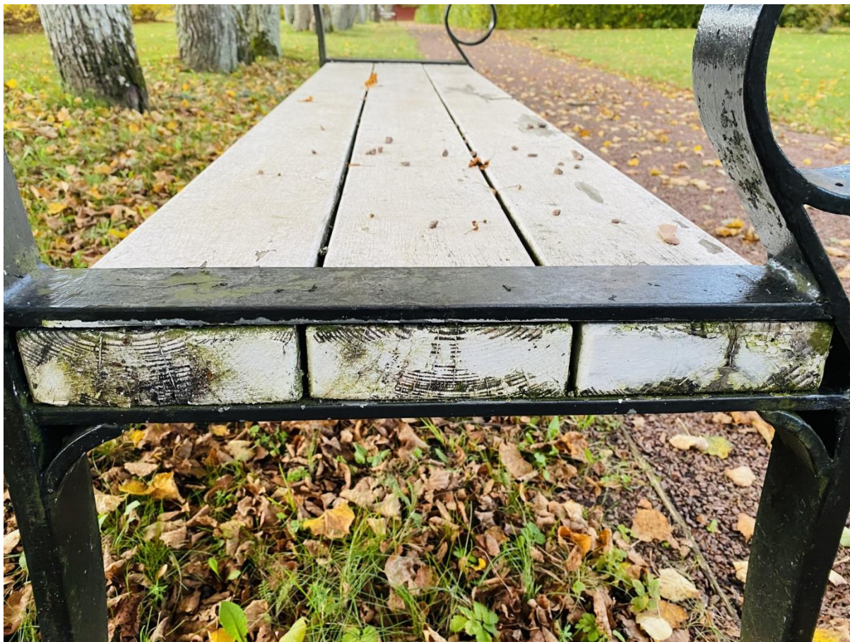
Foto 3. Niiskuskahjustusega lauaotsad ja korrosiooniga karkass. Autori foto
